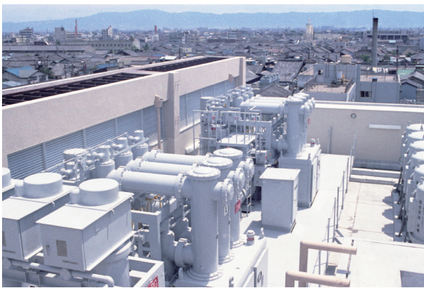
図7 天下茶屋変電所写真
