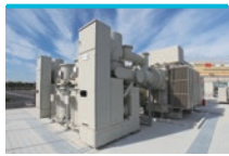
77kV特高受変電設備
