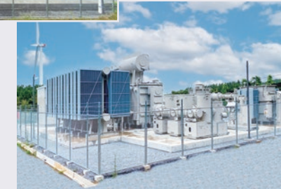
プロジェクト変電所
