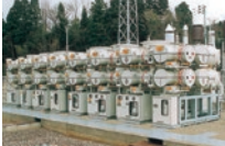
154kV ガス絶縁開閉装置
