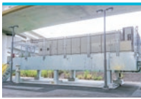
環境配慮型変電塔
