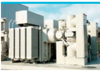
66/77kV 油入変圧器
