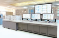
水処理集中監視 制御システム
