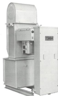
旧 タンク形コンデンサ設備
