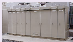
22kVガス絶縁開閉装置
