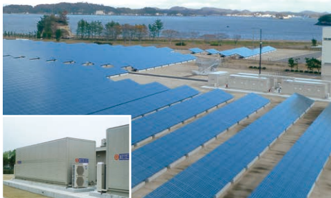
東北電力株式会社 仙台太陽光発電所 様 フルターンキー施工 (塩害対策用密閉型パッケージなど納入) 2MW 宮城県
