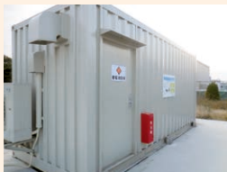
蓄電池収納コンテナ
