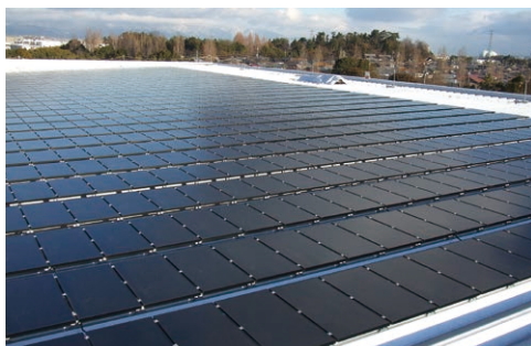
不二電機工業株式会社 みなみ草津工場 様 CIS太陽電池設置 100kW 滋賀県
