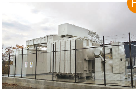
ユーラス豊頃ソーラーパーク 様 交流22MW。66kV特高設備を納入 22MW 北海道
