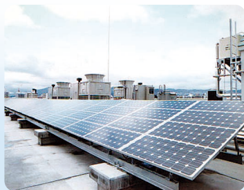
陸屋根設置事例
