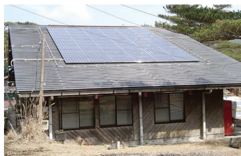
九州地方環境事務所 えびの高原キャンプ村 様 国立公園内に蓄電池付き 独立型・連系システム併用設置 10kW 宮崎県
