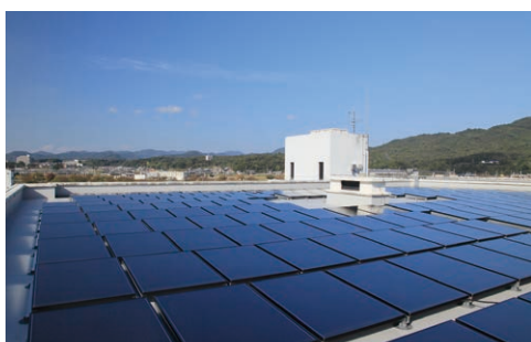
兵庫県企業庁 三田浄水場 様 フルターンキー施工 (自立運転機能付パワーコンディショナなど) 440kW 兵庫県
