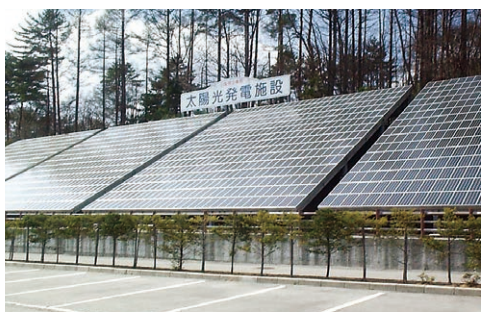
山梨県企業局丘の公園 様 公園内の傾斜地に設置 95kW 山梨県
