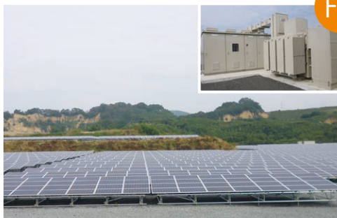
ベナート株式会社 京都グリーンソーラーファーム 様 22kV特高設備、 250kWパワーコンディショナ16台を納入 4MW 京都府
