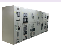
6.6kV高压配電盤
