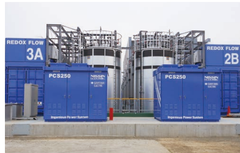
住友電工株式会社 横浜製作所 様 出力安定化装置 (250kW交直変換器盤×2台納入) 500kW 神奈川県
