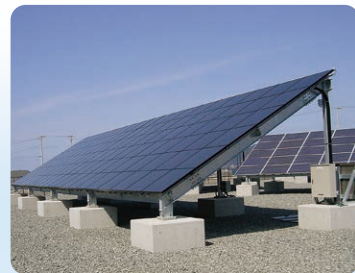
地上設置事例
