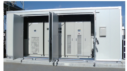
蓄電池システム
