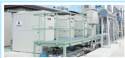
消化ガス発電
