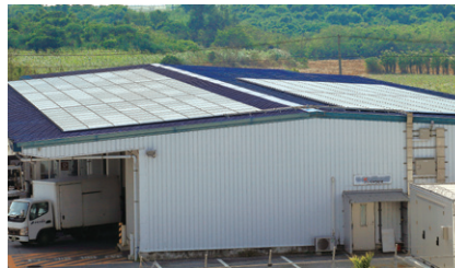
太陽光発電システム
