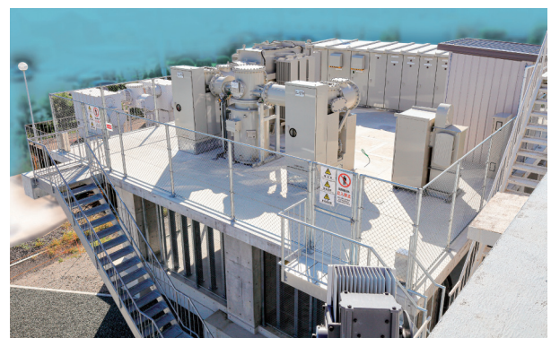
図2 77kV 特高受変電設備
