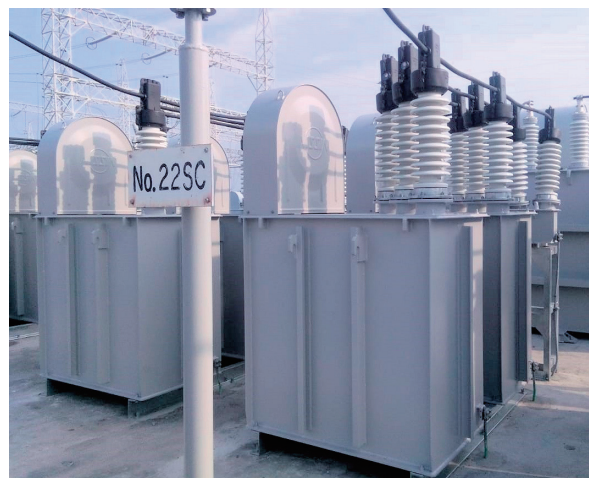
図2 33kV タンク形コンデンサ設備
