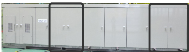
図1 変電塔正面外観（枠内が受電盤）
