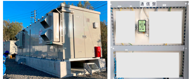
図8 設置状況写真
