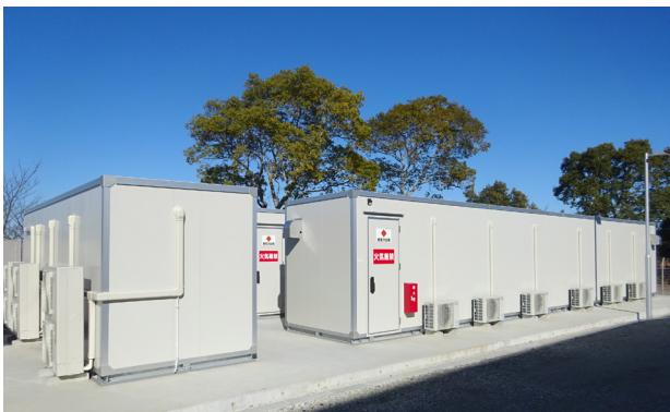
図12 蓄電池システム
