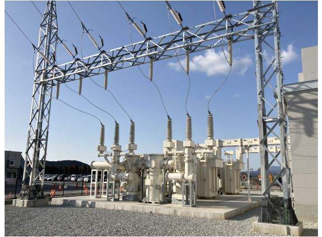
図2 66kV特高連系変電設備
