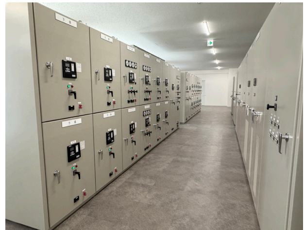
図1 高圧受変電設備
