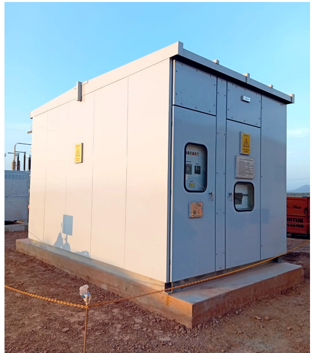
図2 キュービクル形コンデンサ設備
