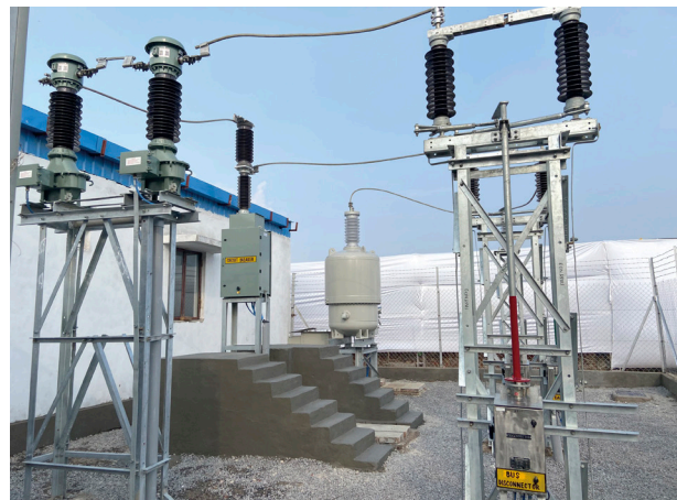
図4 実証試験システム外観
