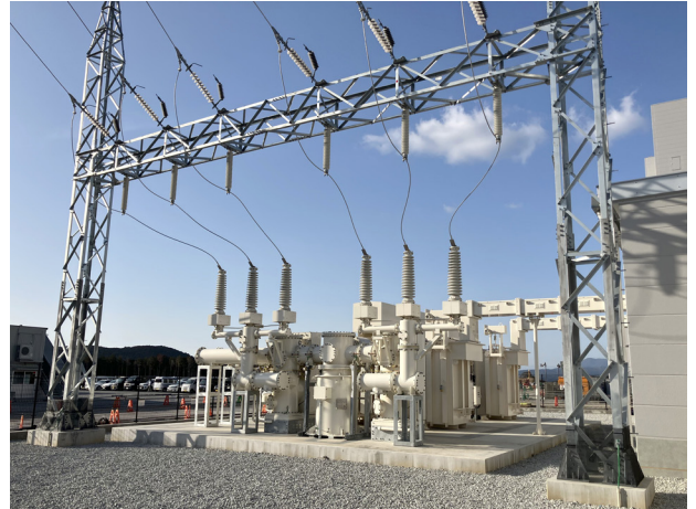
図2 66kV特高連系変電設備
