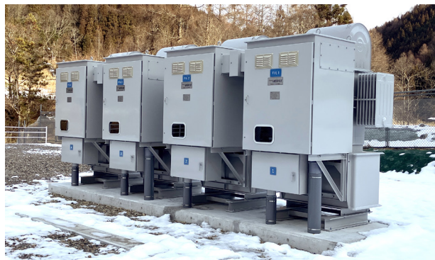
図1 6.6kV 回路用高調波フィルター設備
