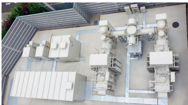
図1 66kV特高受変電設備
